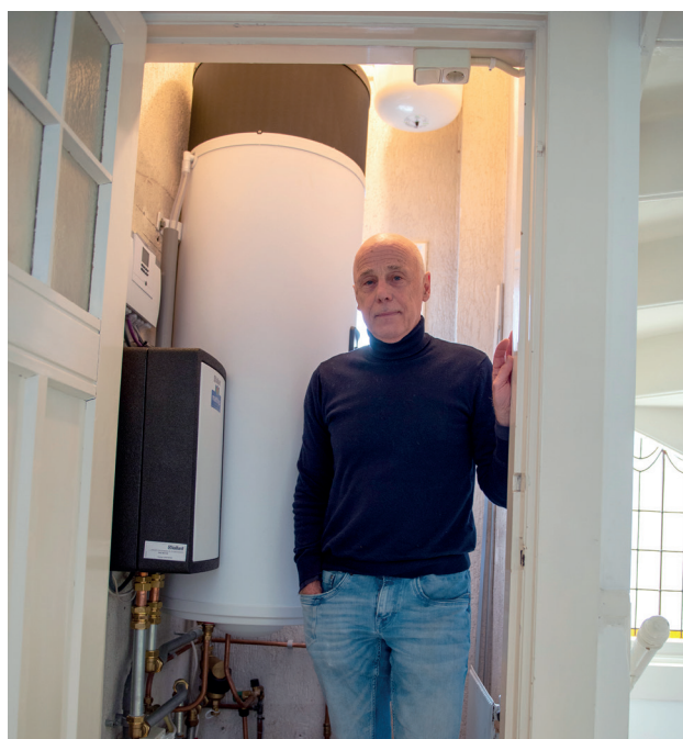
Ruud van Duijn in de 'machinekamer'. De (stille!) warmtepomp staat op een plat dak tegen het huis aan.
